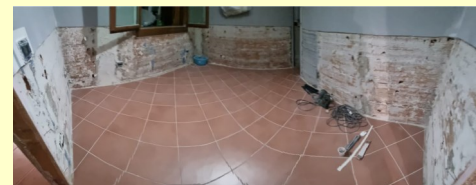
Questa una delle stanze delle abitazioni alluvionate. Tutti i mobili sono persi e i muri devono essere di nuovo intonacati.
